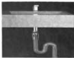
B.洗手池下水管
