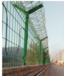
图2 安装了电磁感应式震动电缆的围墙
